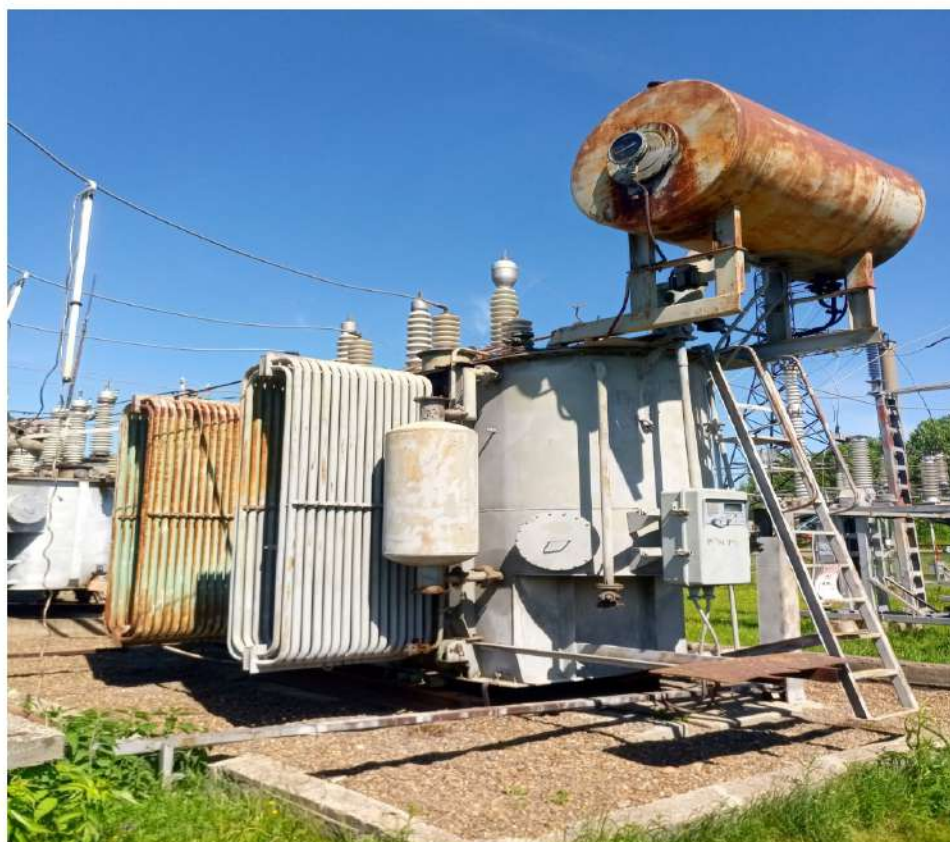
ОРУ-110 кВ, силовой трансформатор 110/35/10кВ, диспетчерское наименование «Т-1» подстанция 110/35/ кВ Высокий Яр
