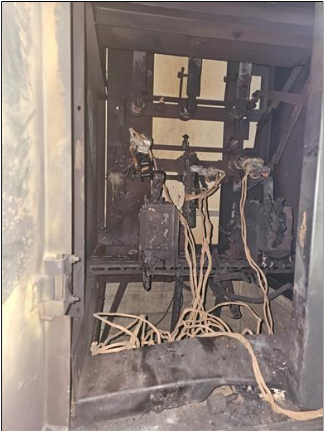
Ячейка № 1, в которой произошёл несчастный случай. Шины в верхней части ячейки находились под напряжением во время производства работ
